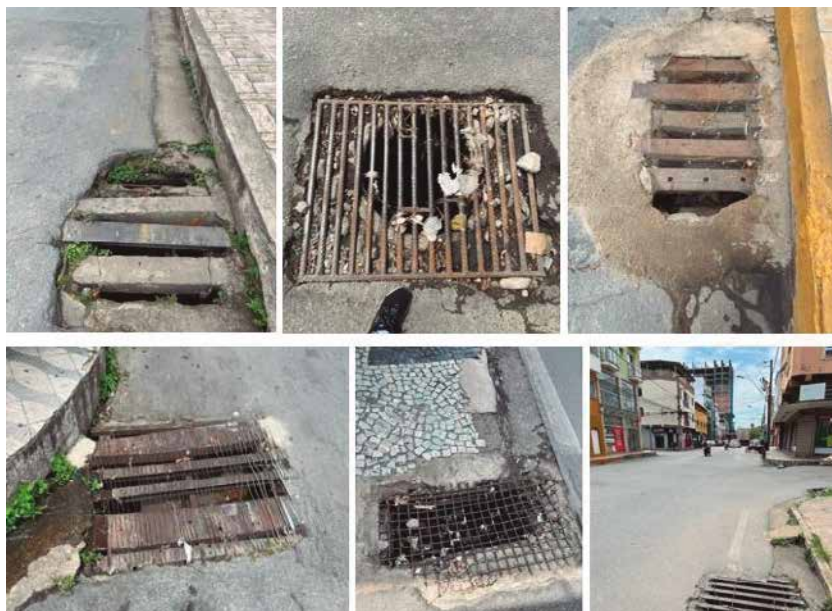
Figura 6: Coletânea de bueiros existentes na baixa vertente e área plana do bairro Matosinhos
